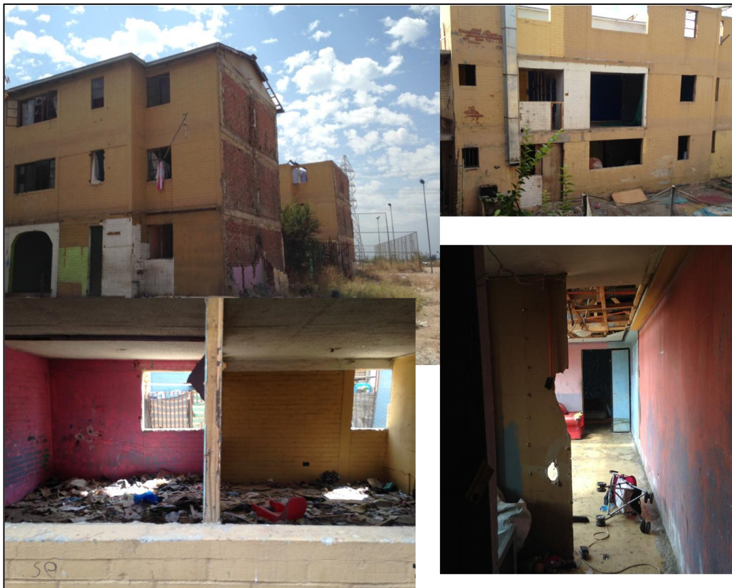
Imagen N° 11: Estado físico de block sin demolición
