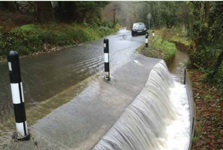
Imagen N° 52: Carretera que actua como vía de inundación
