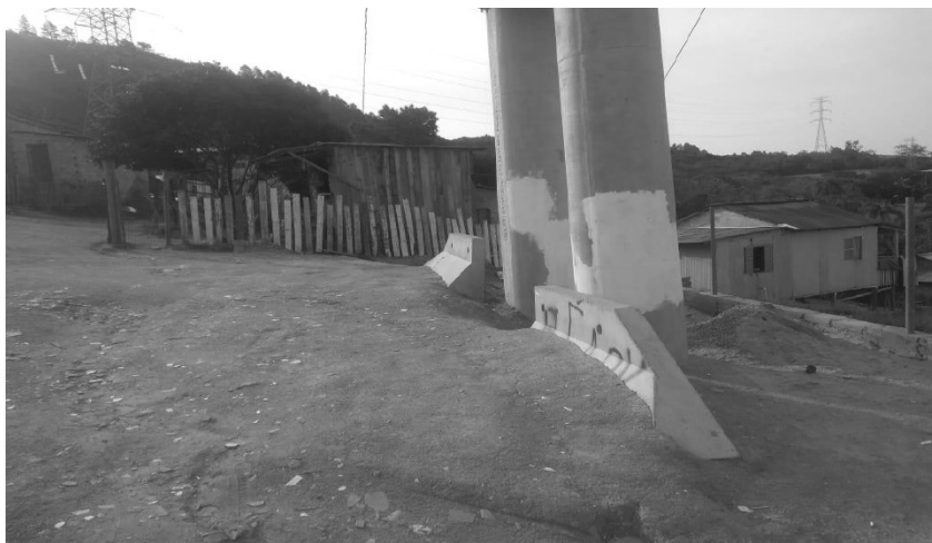
FIGURA 6. É PROIBIDO EDIFICAR PRÓXIMO A CABOS DE ALTA TENSÃO, TAMBÉM NA VILA UNIÃO
